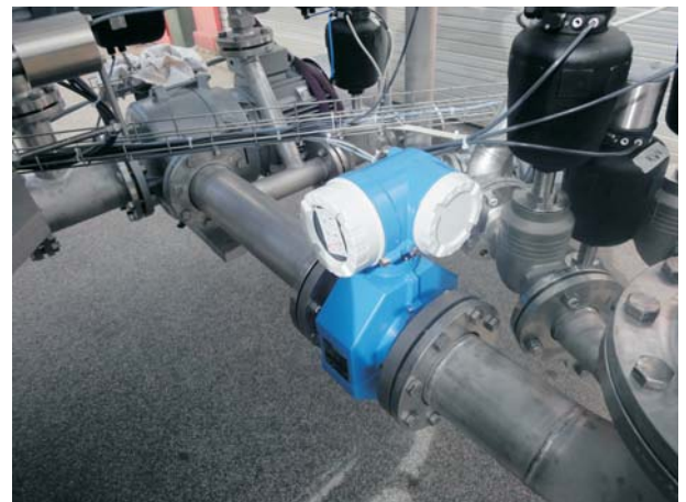
Durchflusskontrollierte Hochleistungs-Umwälzanlage Flow-meter controlled high-power circulation equipment
